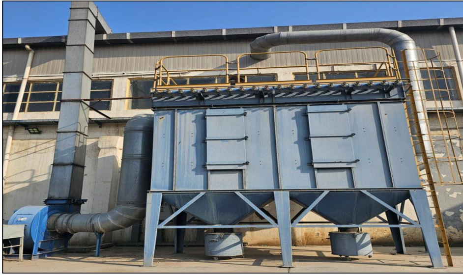
الشكل (5) : يوضح جهاز استخلاص البخار والغاز وتصفية الهواء داخل المعمل
